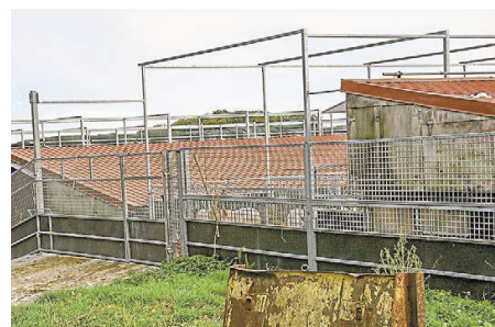
Als Wildschwein-Schutz ist der Stall doppelt eingezäunt. Zudem lässt sich darüber ein Netz spannen.
