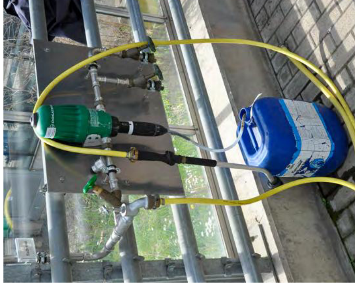
Flüssige Nachdüngung mit Hilfe eines Dosierungsgerätes
